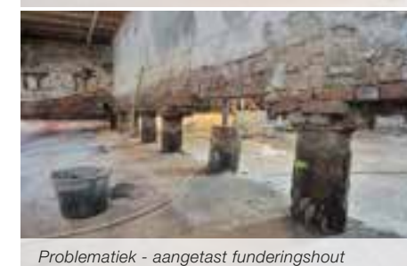
Problematiek - aangetast funderingshout
