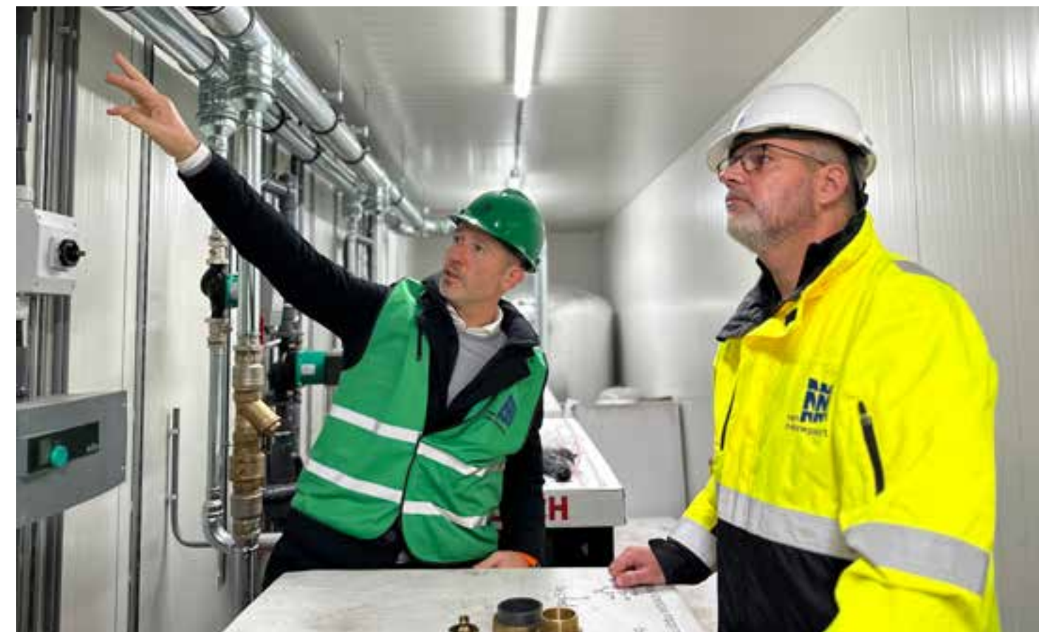
Uitleg over duurzame systemen Van Nieuwpoort
