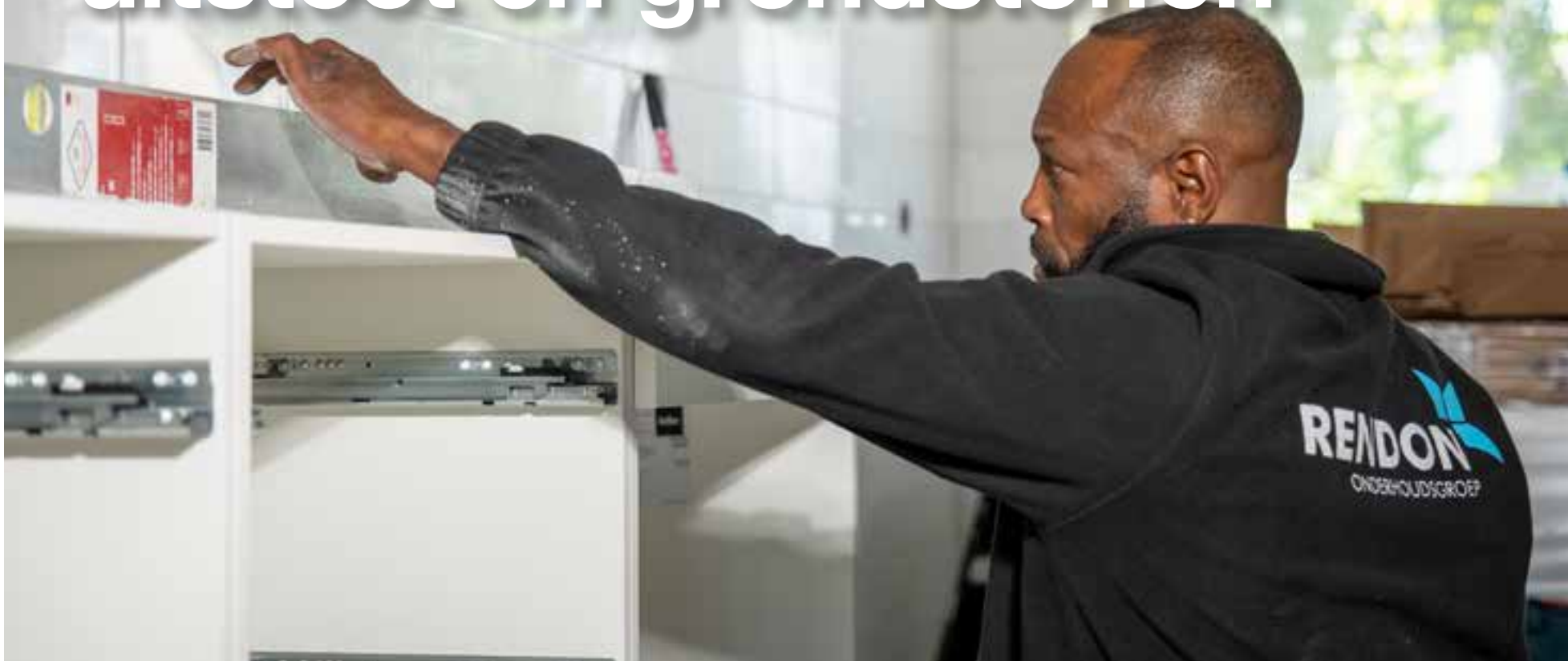
Bij de renovatie van 70 woningen voor woningcorporatie Vidomes werden sanitair, keukens en tegels hergebruikt.
